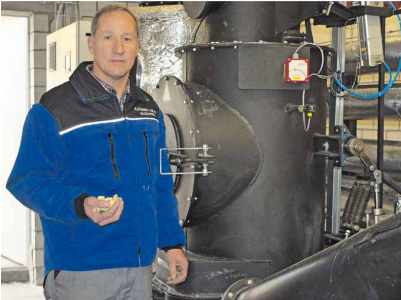
Aus Holzschnitzeln Wärme und Elektrizität gewinnen: Urs Steinger vor seiner Holzvergasungsanlage. Foto Katja Hrup
